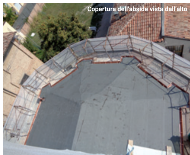
Sommità delle pareti del cleristorio, raddrizzate o ricostruite, in attesa delle strutture di copertura
